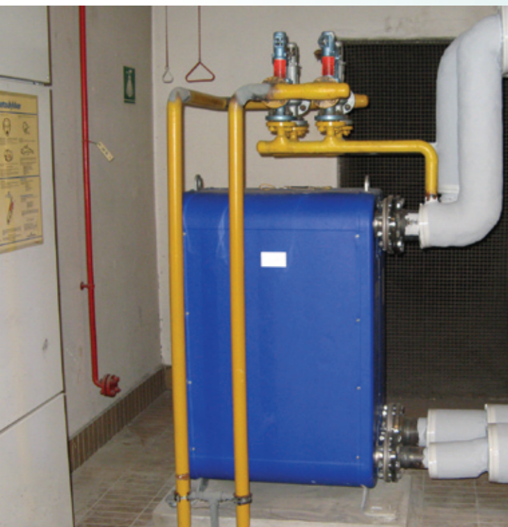
En vekslerinstallation som denne på 3 MW er tilstrækkelig til at opvarme ca. 40.000 m 2 bebyggelse
