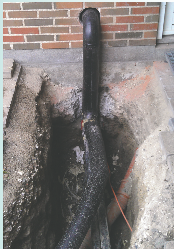
Man har anvendt højisolerede rør i projektet med lavtemperatur. Og dermed meget tykke rør med bukninger.
